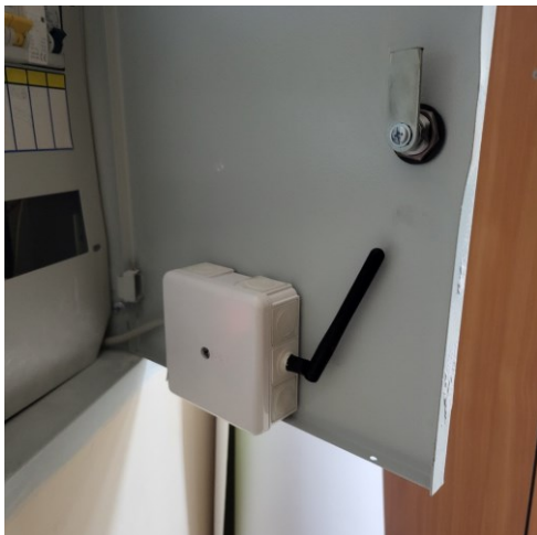
Рисунок 8 – Змонтований блок керування зовнішнім освітленням, встановлений в електрощиті аудиторії
