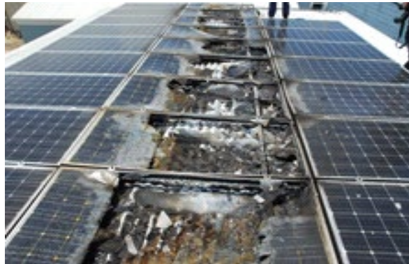
Рисунок 4 – Пожежа сонячних панелей на даху будівлі
