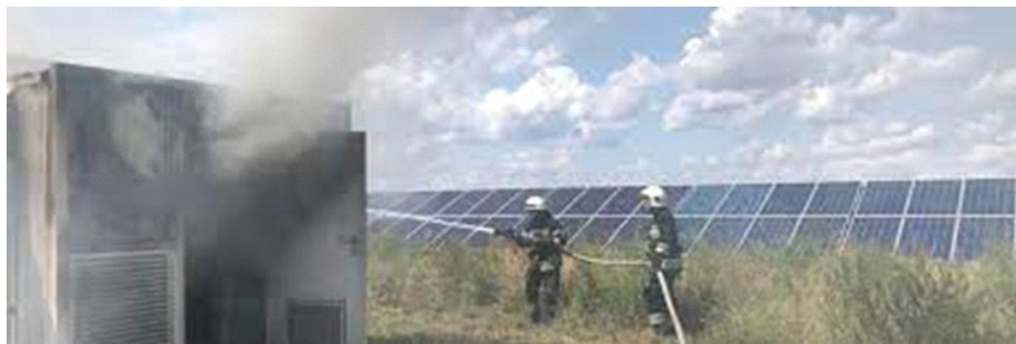
Рисунок 3 – Займання проводки та трансформаторів на території фотоелектричної станції в Херсонській області
