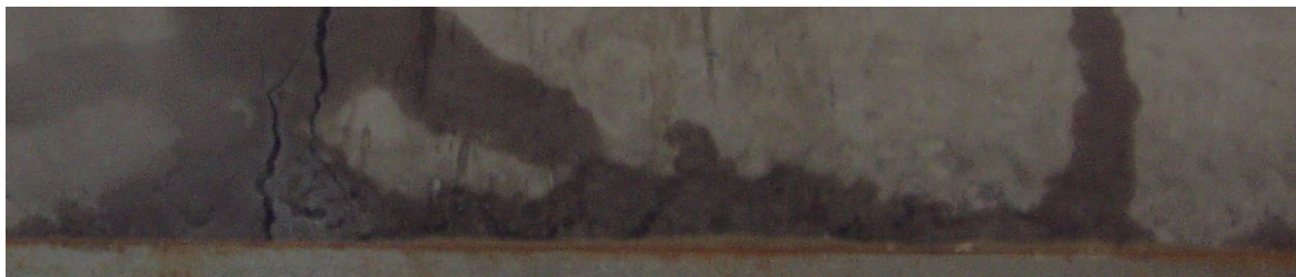
Рисунок 4 – Зовнішній вигляд дефектів бетону, що виникли у бетоні зразків залізобетонних сходових маршів після вогневих випробувань
